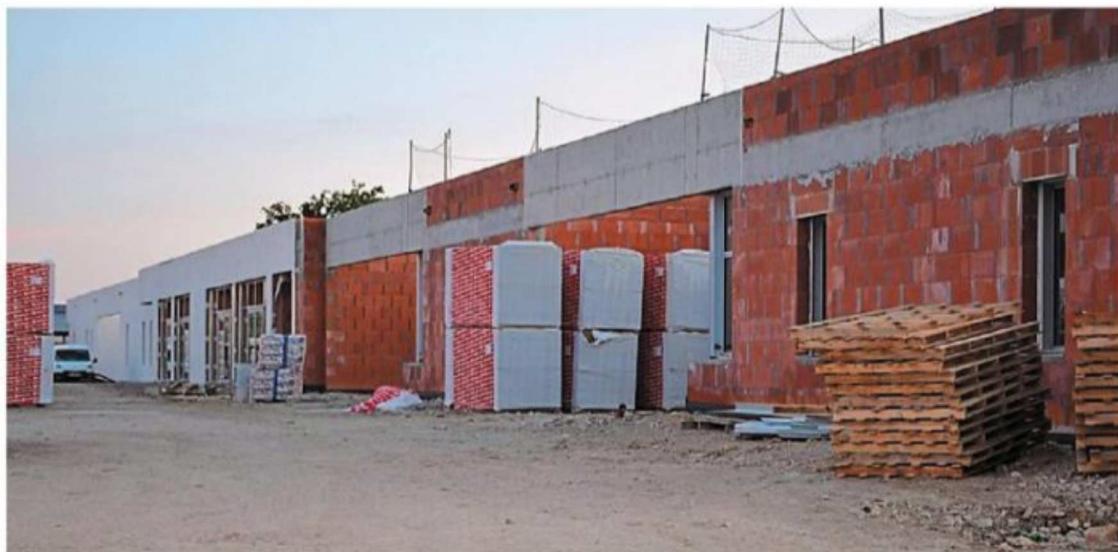
La nouvelle école maternelle n'ouvrira pas en septembre, un retard dû à des problèmes de gros œuvre | CREDIT PHOTO : QUEST FRANCE
